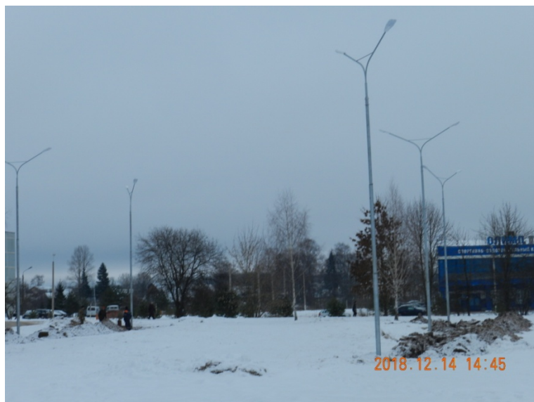
Светильники светодиодные на опорах
